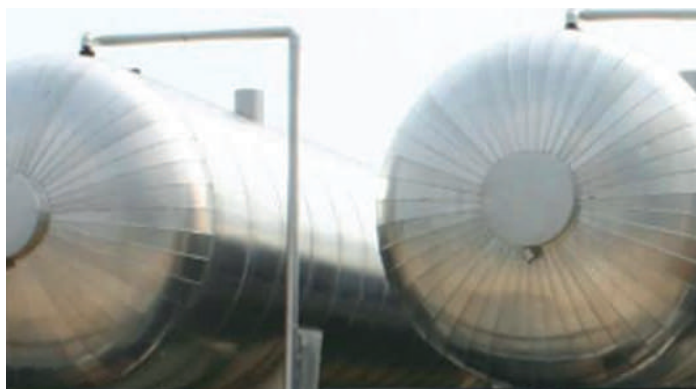
La utilización de CO2 se da en las industrias frigoríficas, centros de distribución (de alimentos congelados o refrigerados) y en el supermercadismo es algo común en países de la Unión Europea o los Estados Unidos.
